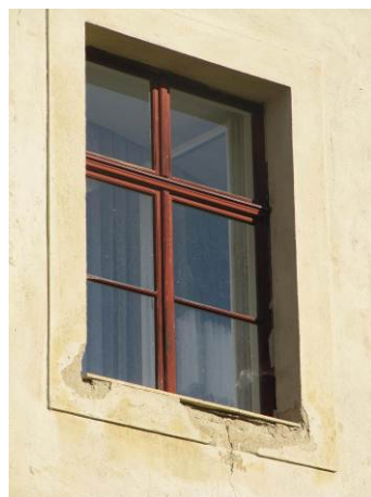
Schadhafter Verputz Ostfassade
