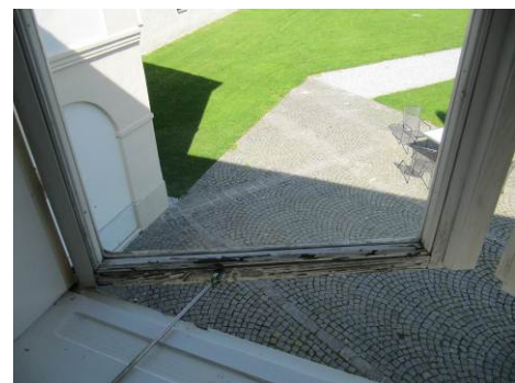
Schadhafter Fensterflügel Südfassade
