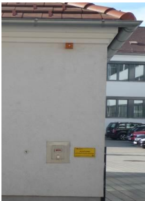
Blitzleuchte und Schlüsseltresor
