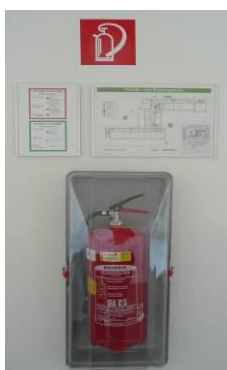
Feuerlöscher „Verhalten im Brandfall“ Fluchtwegsplan
